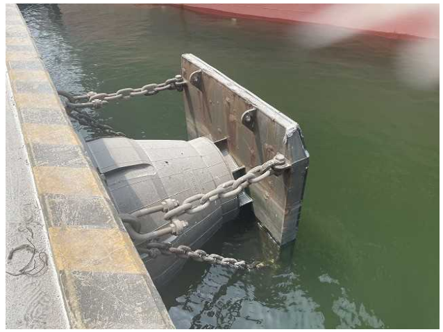
大型防舷材が設置されている。
