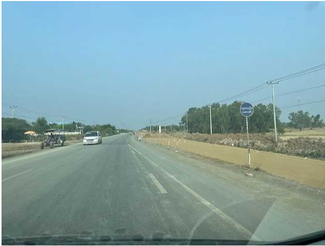
国道 5 号線 シソポンにて国道 5 号線と 6 号線の合流地点から 改修工事されている。
