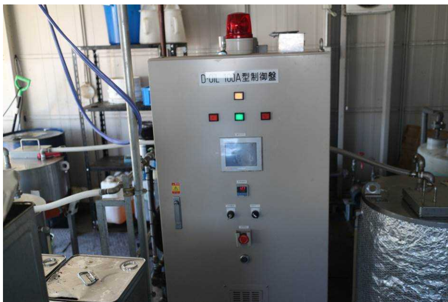
Fig. 3-12 D・Oil 100A の装置 (於 横手市バイオディーゼル燃料化施設, 2016年11月7日撮影)
