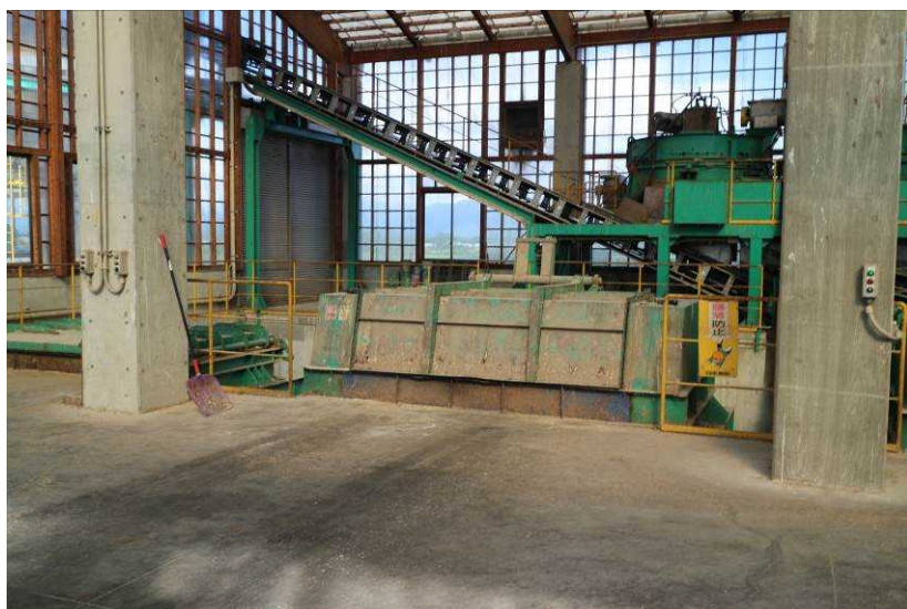
Fig. 4-2 粉碎・酵素混合装置 (於 横手市大雄堆肥センター, 2014 年 9 月 16 日撮影)
