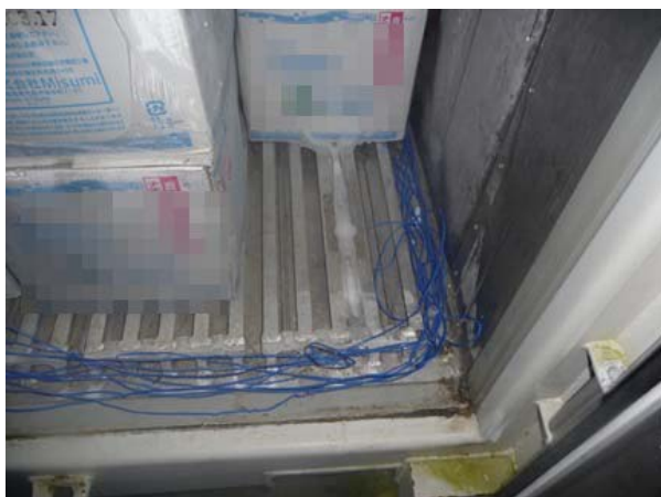
【図 26】 ドレンホールとそのレールに氷
