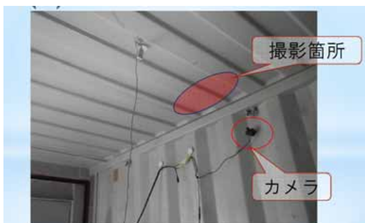
図 15: コンテナ B 内天井のビデオカメラ設置状態
