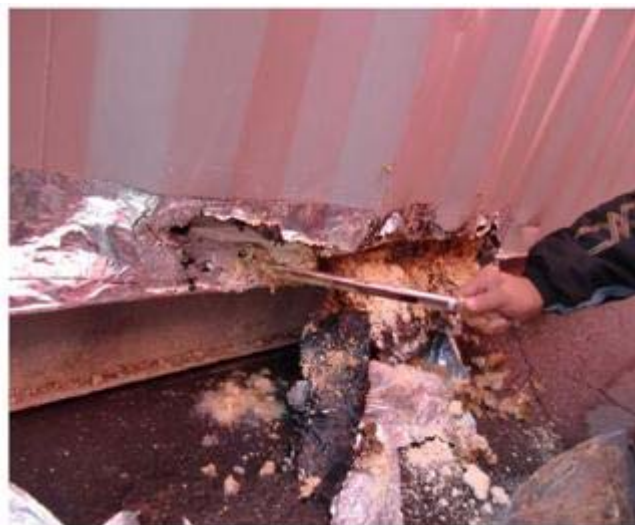
写真 10：コンテナ下部側壁の亀裂
