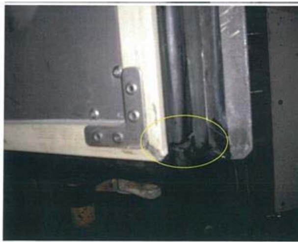
写真2：ドア下部ラバーガスケット欠損部
