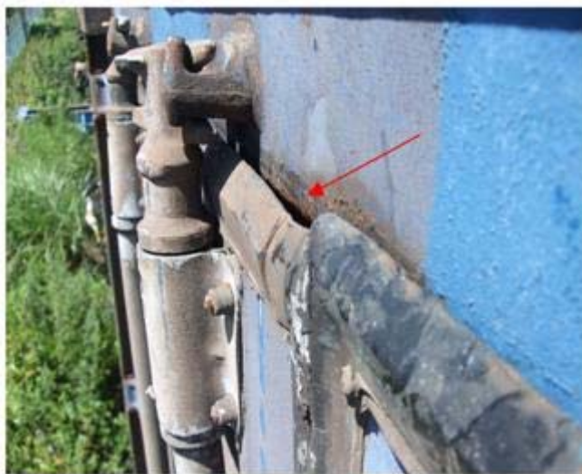
写真 9：ドアの曲損による隙間
