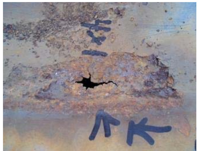
写真 8：コンテナ天井板腐食による穴あき
