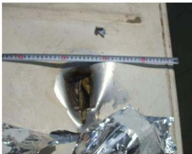
写真3：コンテナ天井の穴
