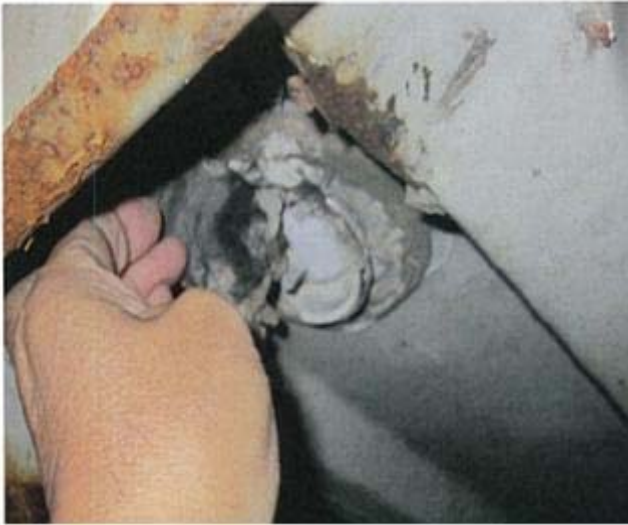
写真5：ドレンホールブーツ脱落
