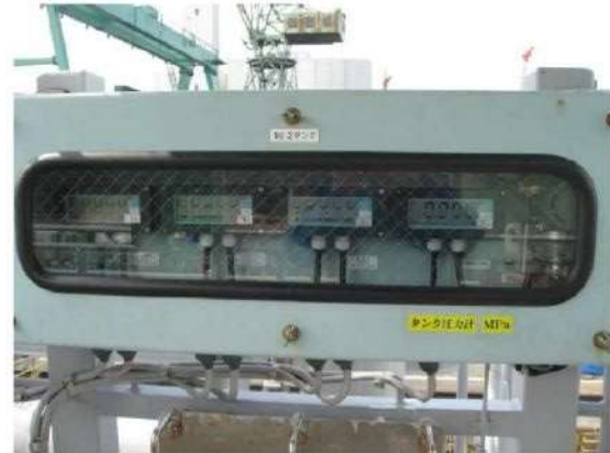
デッキ上設置状態(温度、圧力計の表示部)
