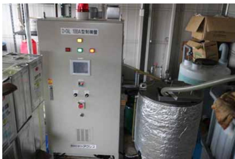
Fig. 3-22 D・Oil 100A の装置外観 (於 横手市バイオディーゼル燃料化施設, 2013年12月10日撮影)
